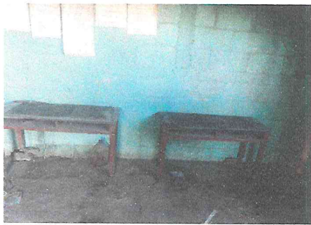
Foto 3: Mesas de cocina en mal estado.
