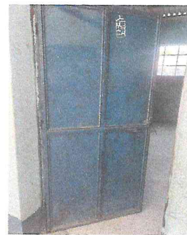
Foto 6: Puerta de aula deteriorada.
