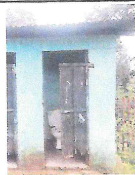
Foto 6: Puerta de sanitario incompleta.
